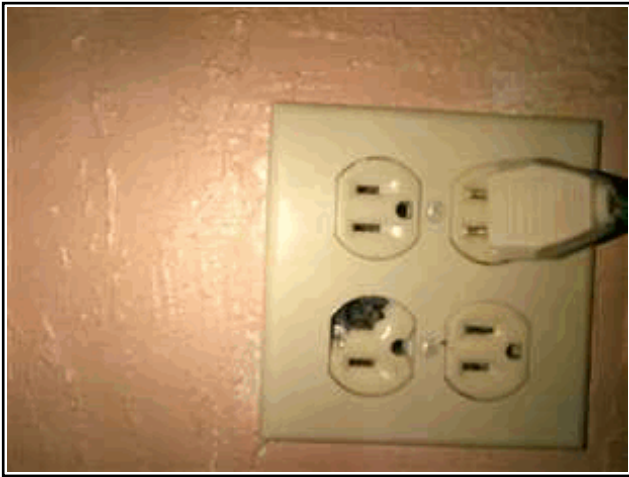
Room 164 - Broken outlet.jpg
